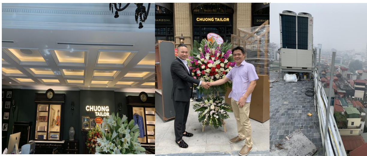
Công trình: Cung cấp và lắp đặt hệ thống điều hòa VRF Mitsubishi heavy cho tòa nhà Chương Taylor – số 28 Cửa Bắc – BD – Hà nội
