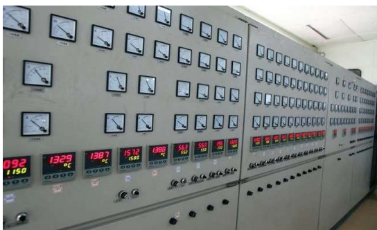
Trạm cấp điện
