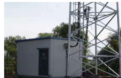
Trạm phát sóng
